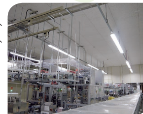
秦野工場のLED照明
