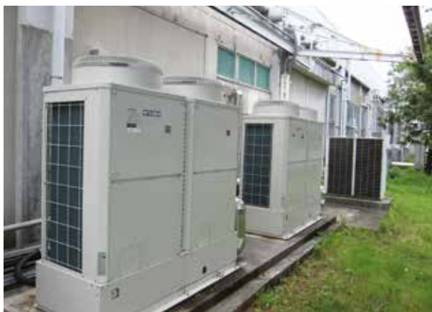
更新した冷凍設備(泉佐野工場)
