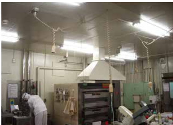
更新したLED照明(埼玉工場)
