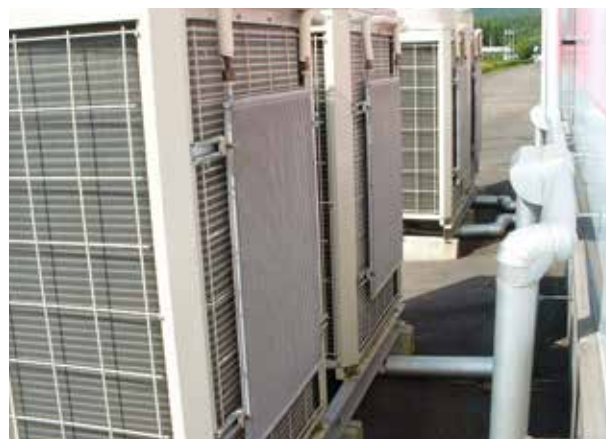
室外機の冷却装置(富士裾野工場)
