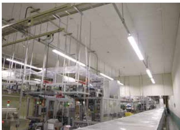
更新したLED照明(秦野工場)
