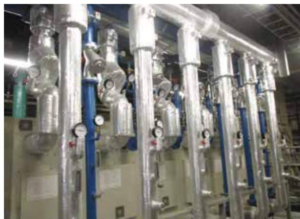
運転変更した冷凍設備(秦野工場)
