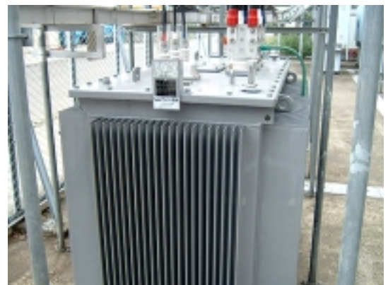
アモルファス型電力変圧器(秦野工場)
