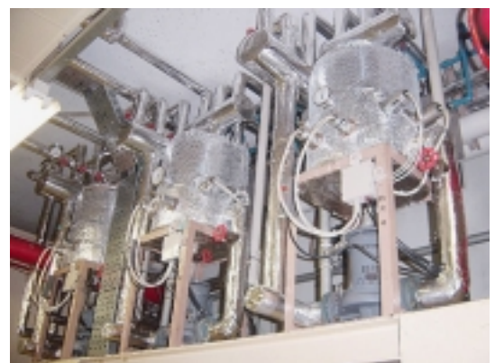
配管での放熱防止(平塚工場)
