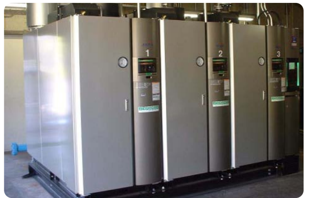
更新した小型貫流ボイラー
